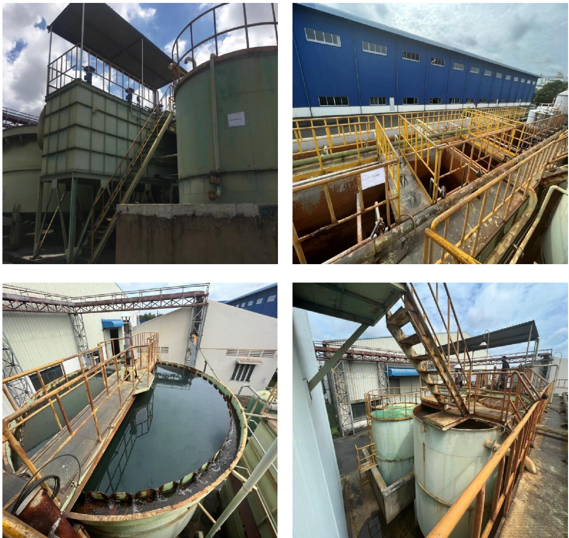
Hình 3. 6. Hệ thống xử lý nước thải tại Nhà máy
